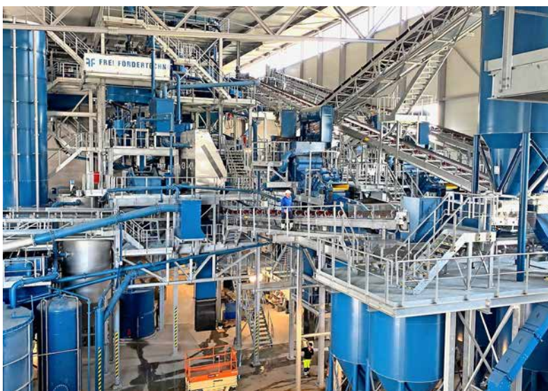
Die Frei Fördertechnik AG baute die nassmechanische Aufbereitungsanlage, die eine breite Palette an Rückständen aus der Baubranche verwertet.
