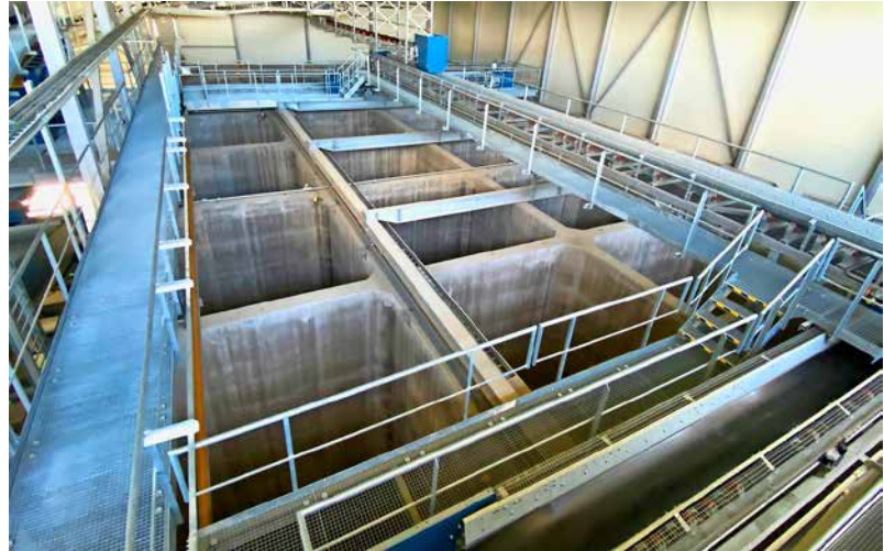
Die Materiallagerung und die Dosierung erfolgen in einer Siloanlage mit 32 Materialsilos, die durch einen Verschiebewagen beschickt werden.
